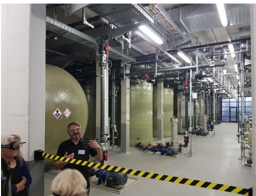
Untergeschoss mit Speichertanks
