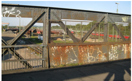
Auf diesen rostigen Charme der alten Brücke muss man zukünftig verzichten. Anders als bei der alten Brücke gibt es bei der neuen auch keine seitlichen Gitter mehr, an denen „Liebesschlösser“ angebracht werden könnten; kl. Foto links: H. Jacobs, alle anderen: Wolfgang Melchert
